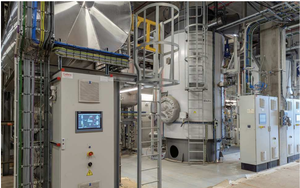
2 chaudières électriques de chacune 5 MW et 7,5 tonnes de vapeur par heure, avec équilibrage de l'usine
