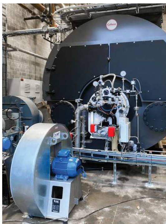
Chaudière à vapeur hybride de 9 t/h, combustion de gaz odorants dans le brûleur
